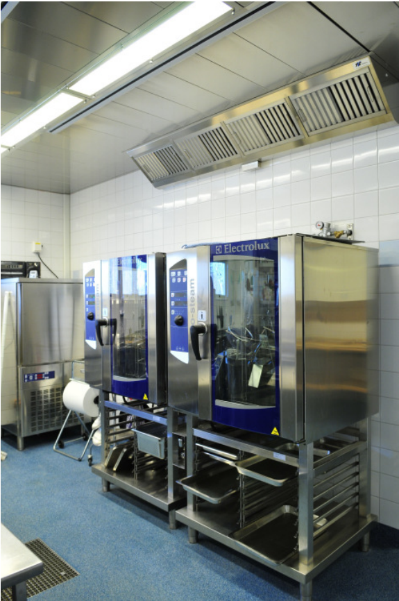
Väggfilterbankar över kombiugnar. Här syns också styrluftsdon i form av spaltluftsridare
