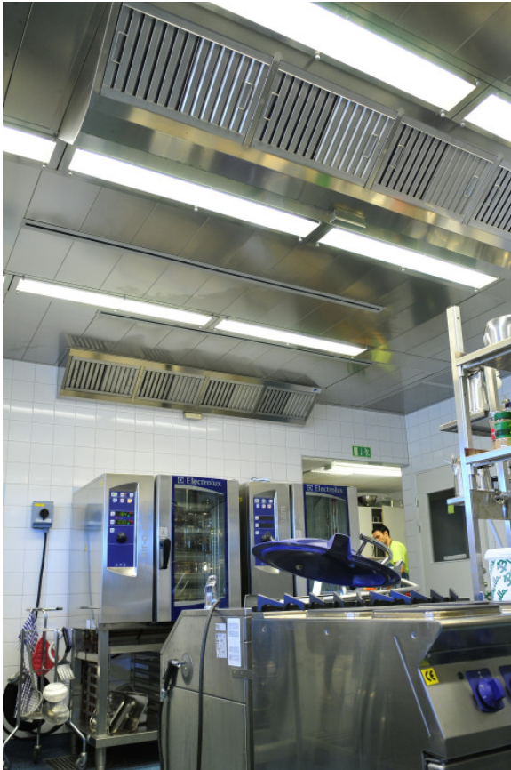
Centrumfilterbankar över kokgrjtor i ett skolkök
